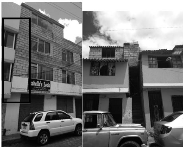
Figura 6. Problemas de choque entre edificaciones en presencia de un sismo.
